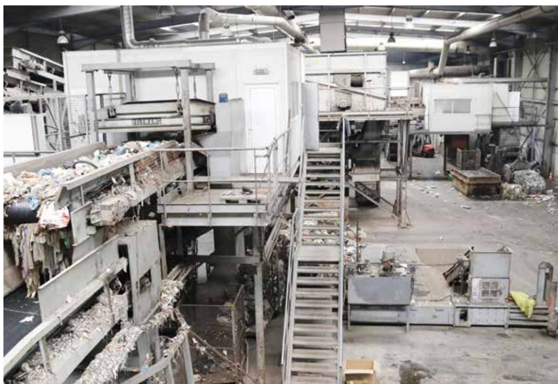
SITUAÇÃO INACEITÁVEL NA RESÍDUOS DO NORDESTE
